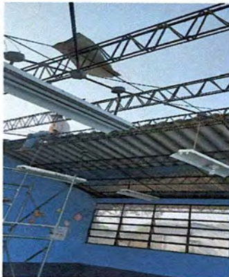
Foto 3: Aulas despejándose del techo deteriorado
